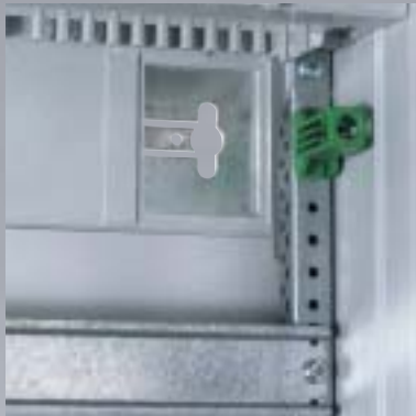
Обширный настенный монтаж с ослаблением натяга встроенного кабеля.
